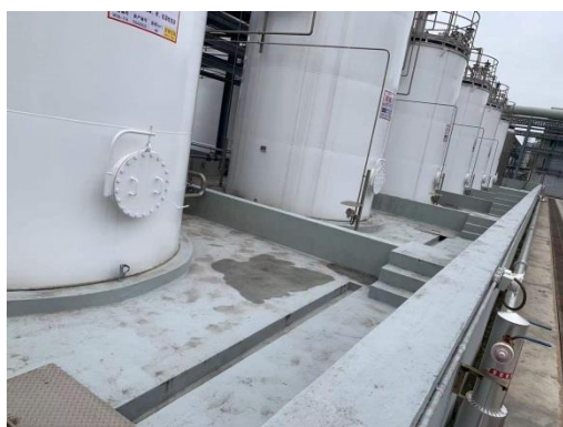
综合储罐区围堰
