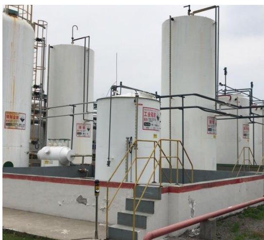
综合储罐区围堰
