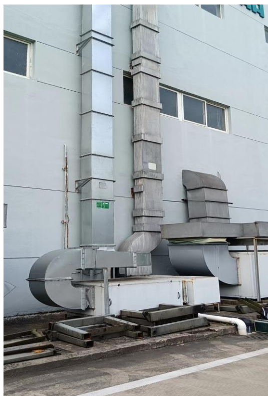
废气处理设施出口
